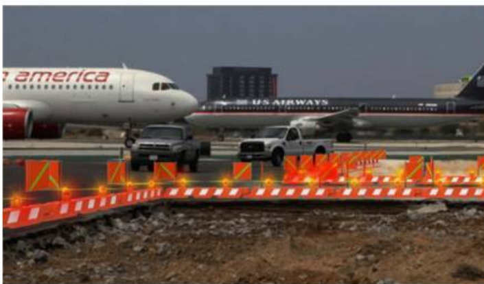
BARRERA DE AEROPUERTO
